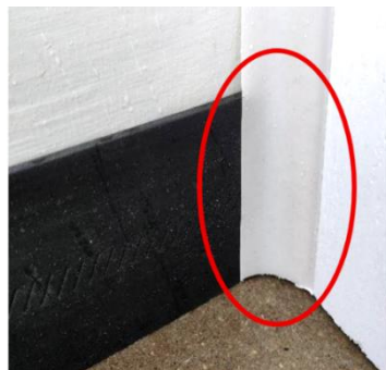
debajo del sello lateral de polímero instalado en el lateral de la jamba
