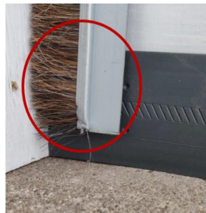
uszczelka pod szczotką zamontowana na drzwiach
