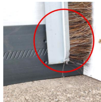
uszczelka pod szczotką zamontowana na drzwiach
