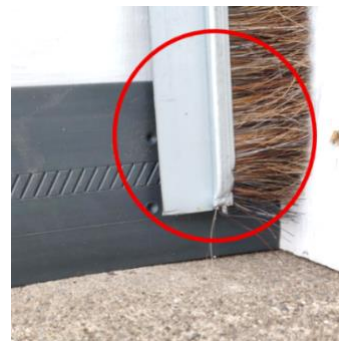
uszczelka pod szczotką zamontowana na drzwiach
