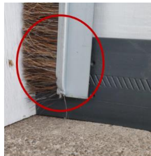
uszczelka pod szczotką zamontowana na drzwiach
