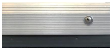
Parte danneggiata dell'AIO nascosta dietro la striscia di montaggio
